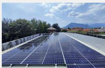
Tetto FV alla scuola Gramsci
